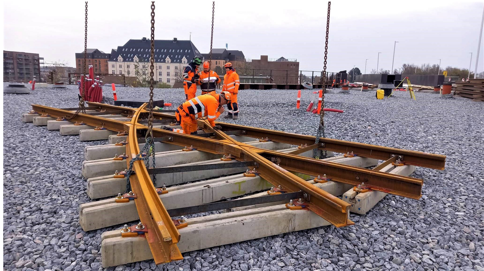
Sporskifter lægges på plads på rampen, der skal føre letbanen til og fra Glostrup Station.
